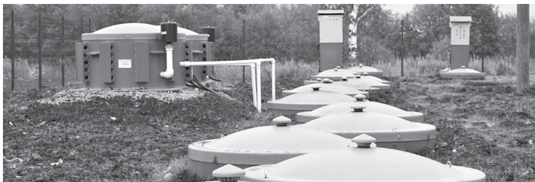
Канализационно-очистная станция в Ладве
